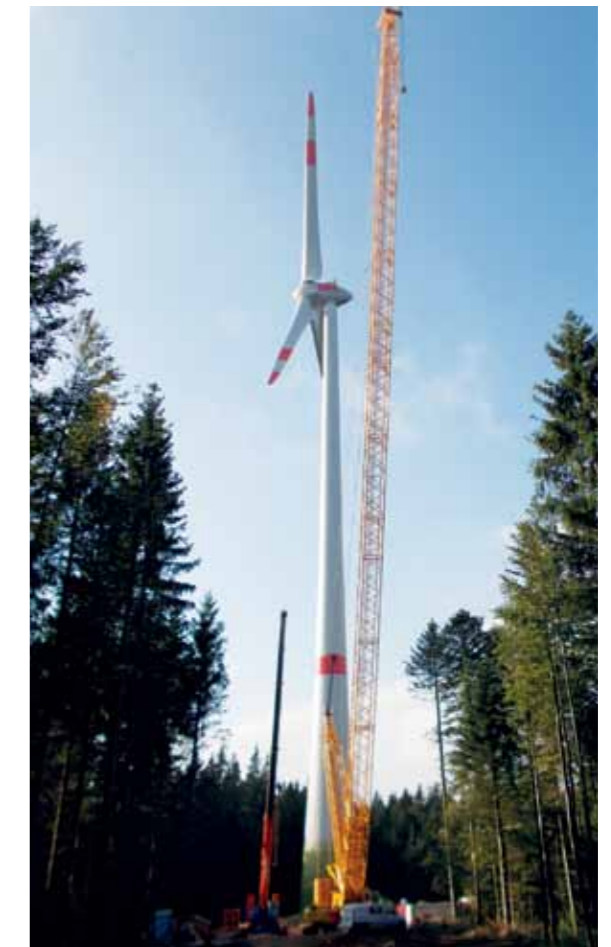
Umladen von Komponenten auf freier Strecke (Bild links oben). Im Schrittempo fährt der Konvoi mit den Rotorblättern durch die Ortschaft (Bild links unten). Bild rechts: Anlagenmontage im Windpark.
