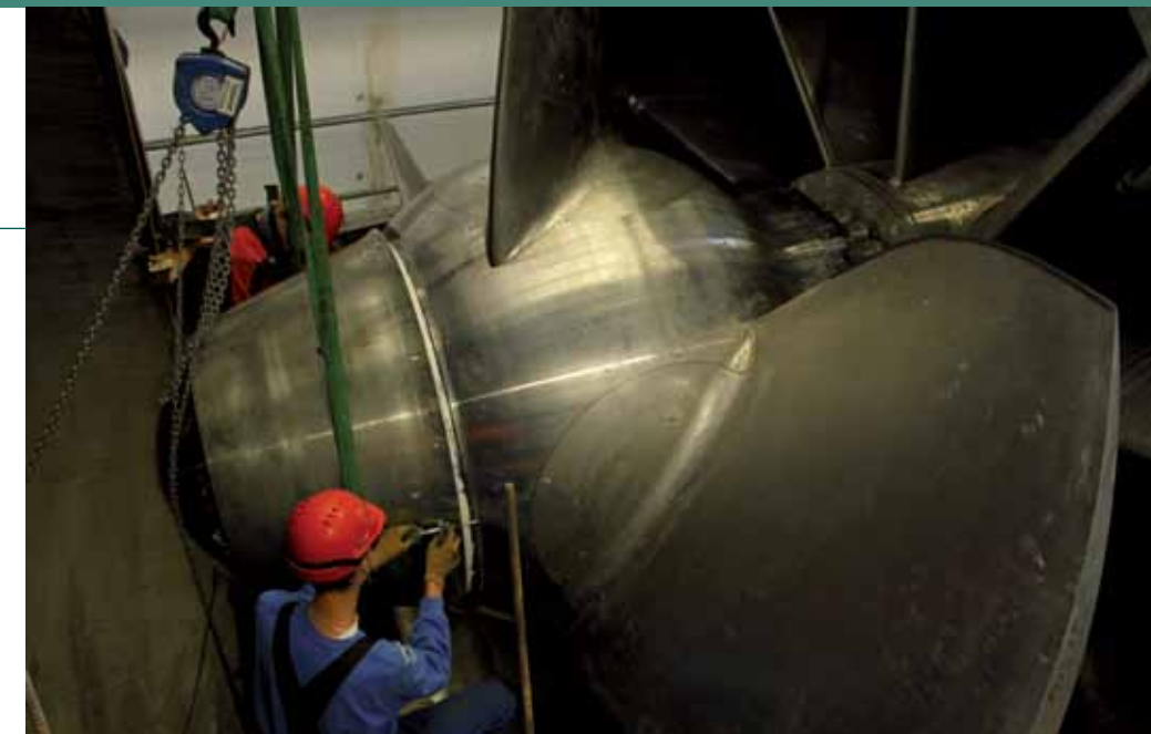
Zweite Turbine dazu geschaltet: Nach Abschluss einer mehrwöchigen Probephase hat ENERCON im Weserkraftwerk erfolgreich den Regelbetrieb gestartet.
