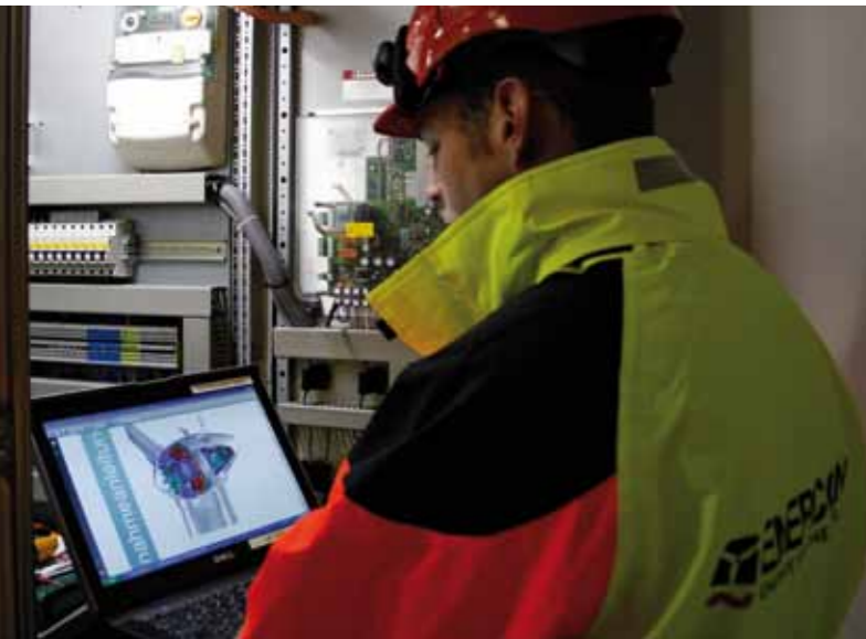
Schneller Informationsfluss: Was der ENERCON Service beim Wartungstermin vor Ort protokolliert, fließt gleich ins neue SIP mit ein.
